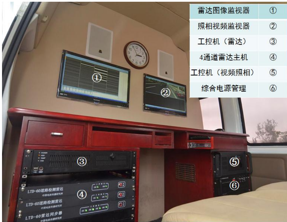
图 2-2 RDRF-V01 道路灾害预警雷达控制处理中心布置
